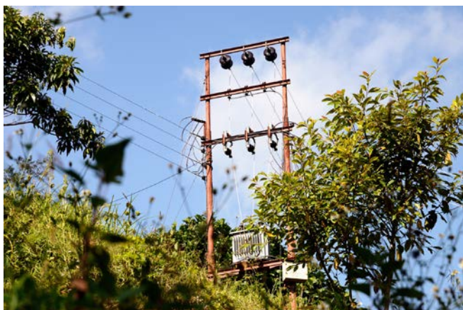
La ligne alimentant le dispensaire partira de ce transformateur
